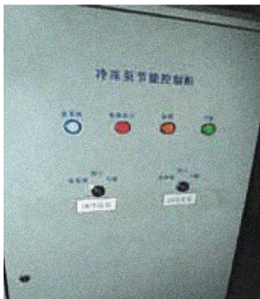
صفحه کنترل پمپ های آب خنک
