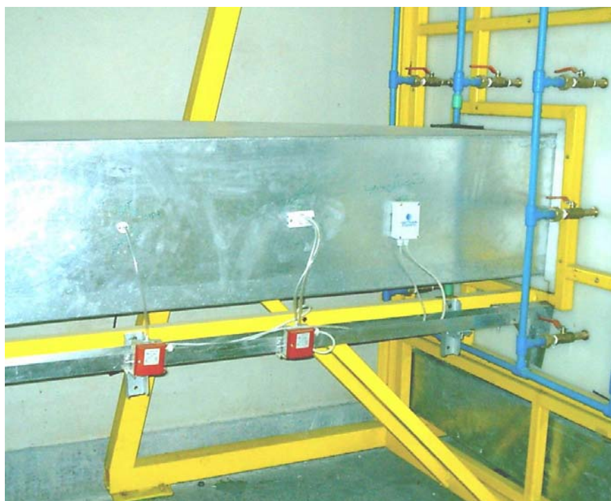
شکل ۱۷- تجهیزات کنترلی نصب شده روی کانال
