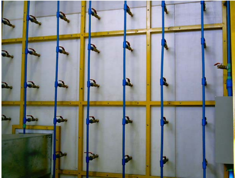
شکل ۹- نمایی از شبکه آبرسانی از پشت دیواره
